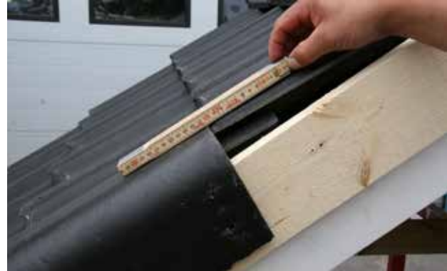
Montagebild 4. Bringen Sie den Universal-Giebel auf die Höhe des jeweiligen Dachsteinformates. So vermeiden Sie horizontale Öffnungen bei den Überlappungen. Mindestüberdeckungen sind auch hier zu beachten.
