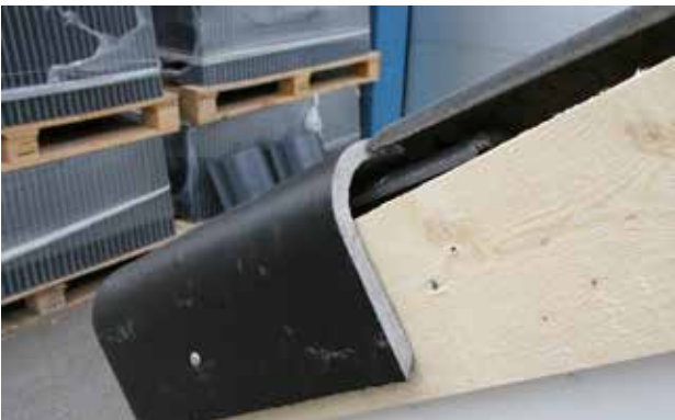
Montagebild 2. Schneiden Sie den Universal-Giebel nach Maß wie beschrieben und montieren Sie ihn mit der Schnittstelle nach oben zeigend gegen den Steinfuß der zweiten Dachsteinreihe (als Provisorium). Eine Arbeitsfuge von 2 bis 3 mm zwischen Universalgiebelkopf und dem jeweiligen Dachsteinfuß der darüber liegenden Decksteinreihe wird empfohlen.
